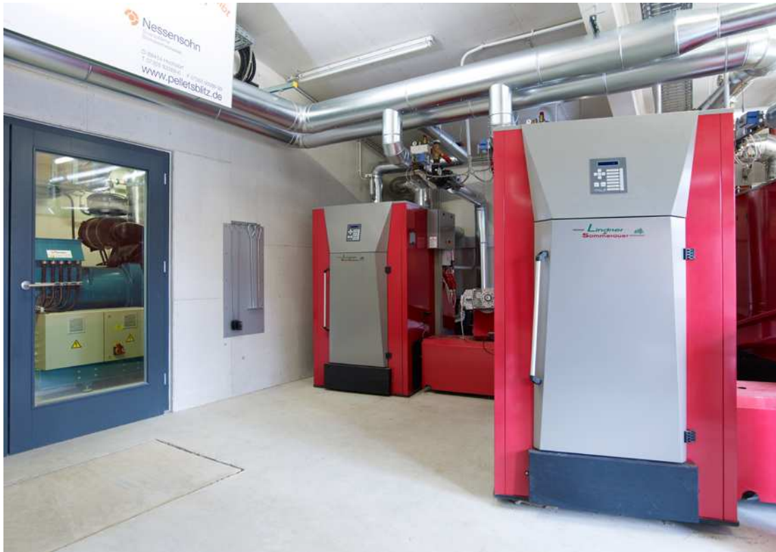
Blick in die Heizzentrale
