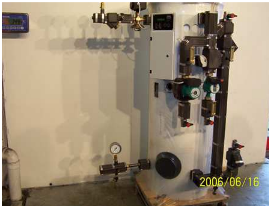
Wärmeübergabestation bestehend aus Pufferspeicher, Pumpen, Regelung, Wärmemengenzähler
