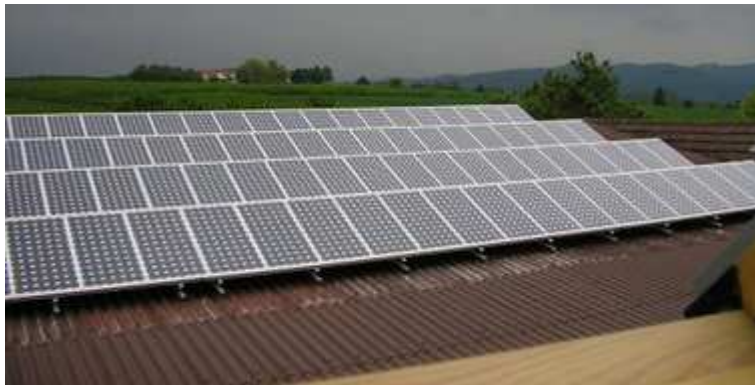
Photovoltaikanlage in Lippertsreute
